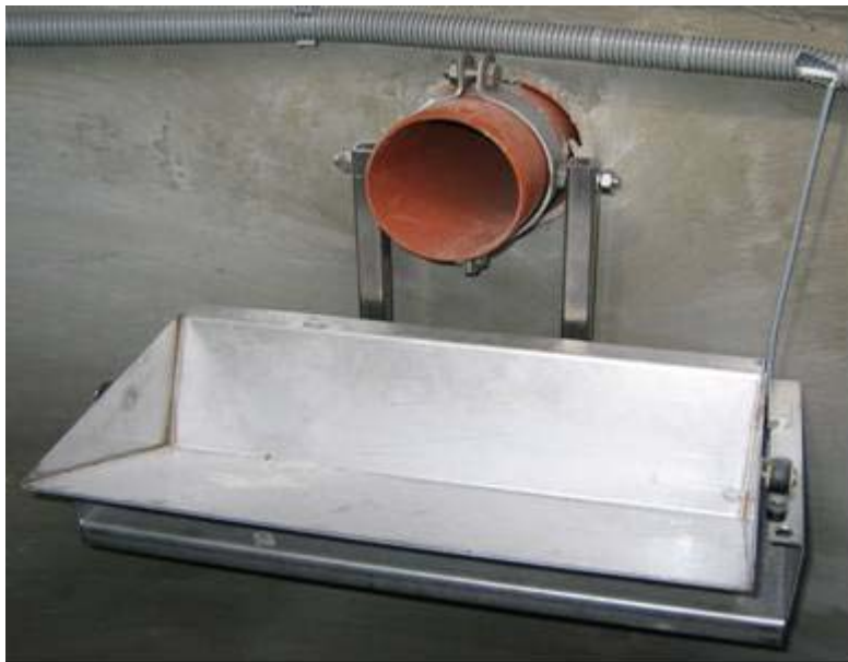
Abbildung 44 Ablaufwippe im Abwasserpumpschacht
