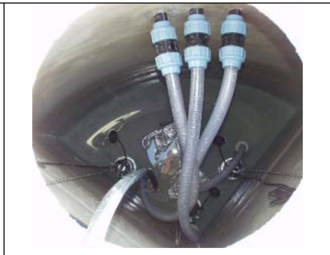
Abbildung 3 3. Kammer der 3-Kammer-Anlage mit Beschickungspumpen
